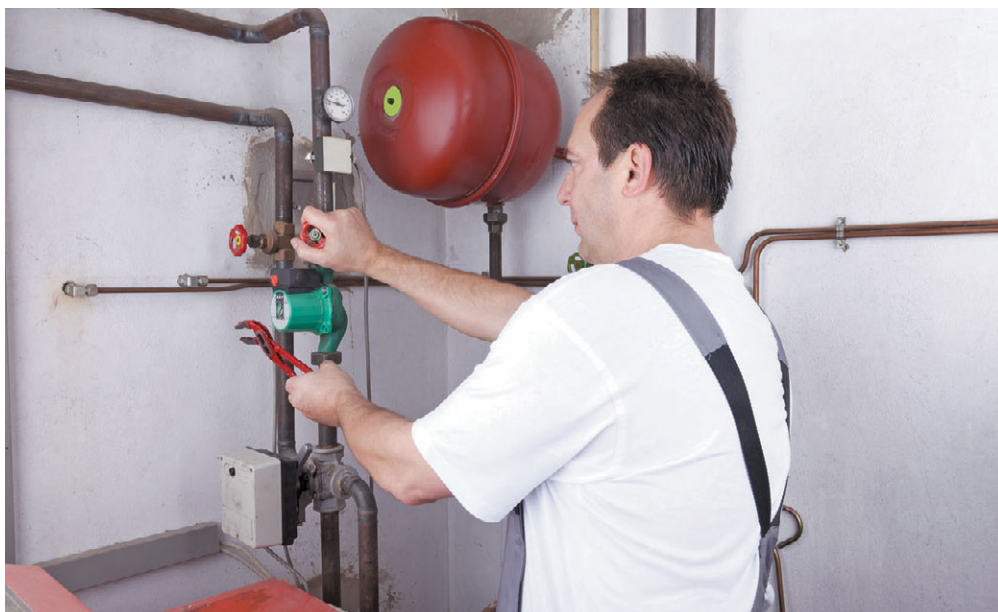
Рис. 12.21. Расширительный бак (красного цвета) предотвращает разрыв труб или котла
