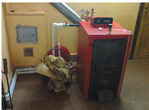
Рис. 12.35. Котельная на твердом топливе
