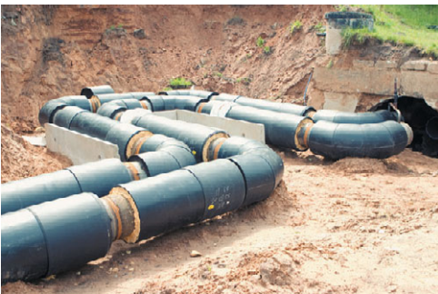
Рис. 5.5. Трубы с утеплительным слоем из минеральной ваты
