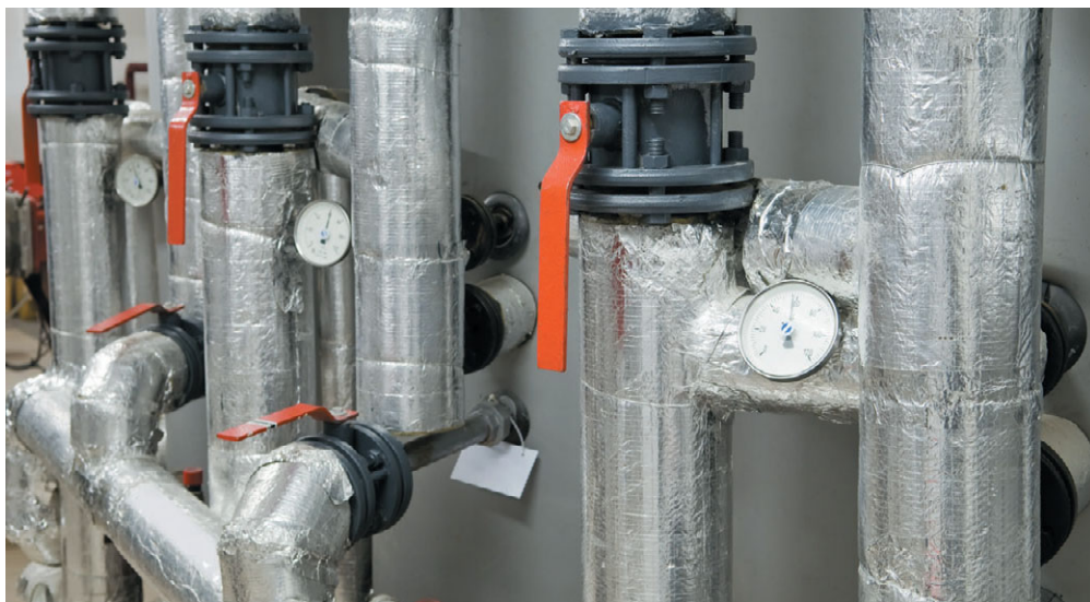
Рис. 12.41. Система трубопровода для минимизации теплопотерь изолирована минеральной ватой, сверху — фольгой
